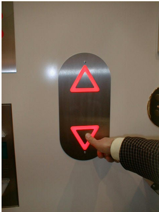
Abb. 1 Außenruftafel für eine Zweiknopfsammelsteuerung
